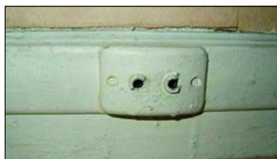
▲ Prise de courant obsolète sans terre
